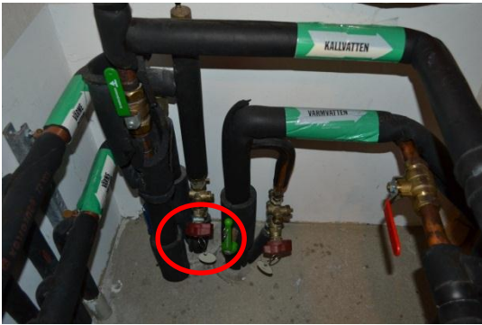
Avstängningsventil för inkommande värme (röd ratt).
