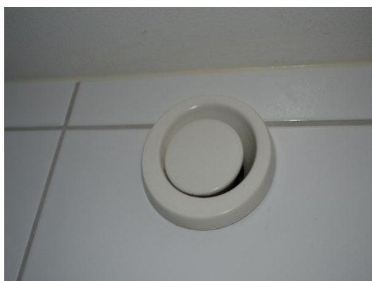
Frånluftsdon (i badrum och tvättstuga).
