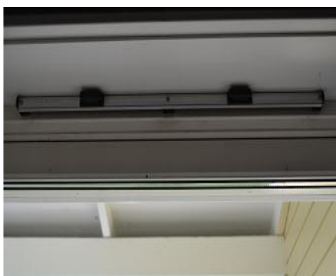
Tilluftsdon (ovan fönster).
